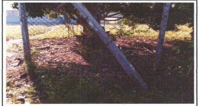
foto 4: se observa que los postes estan en mal estado
